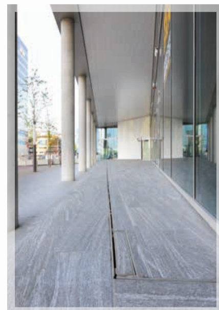
Nur ein schlanker Schlitz und zwei Revisionskästen verraten das Entwässerungssystem im Podest des Eingangsbereichs.
