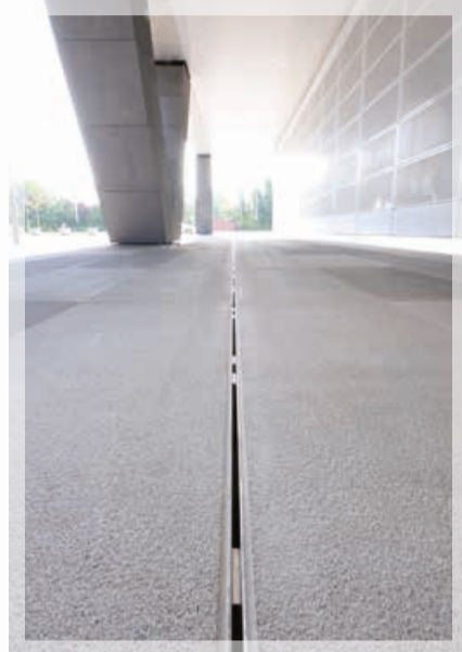
Dezent fügt sich die Schlitzrinne ins geradlinige Design des Laborgebäudes „0|2“.
